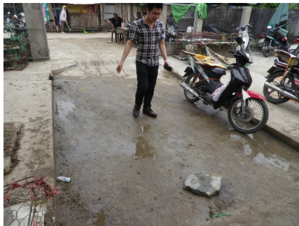
図 5. 車両消毒槽が干上がっている。
